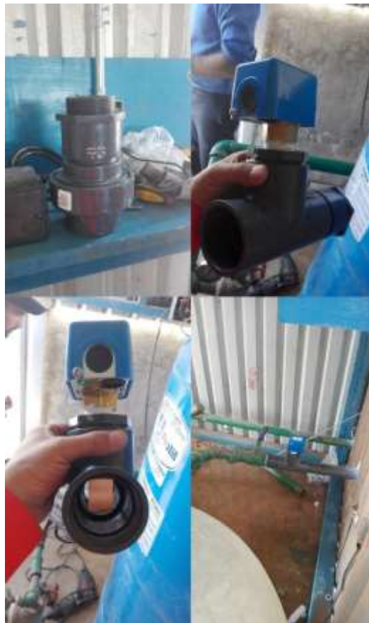
Figura 10: Instalación de Switch de Control de Flujo.
